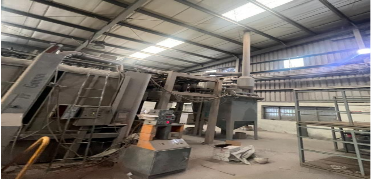
Hệ thống lọc bụi quá trình sơn chai LPG xưởng cũ
