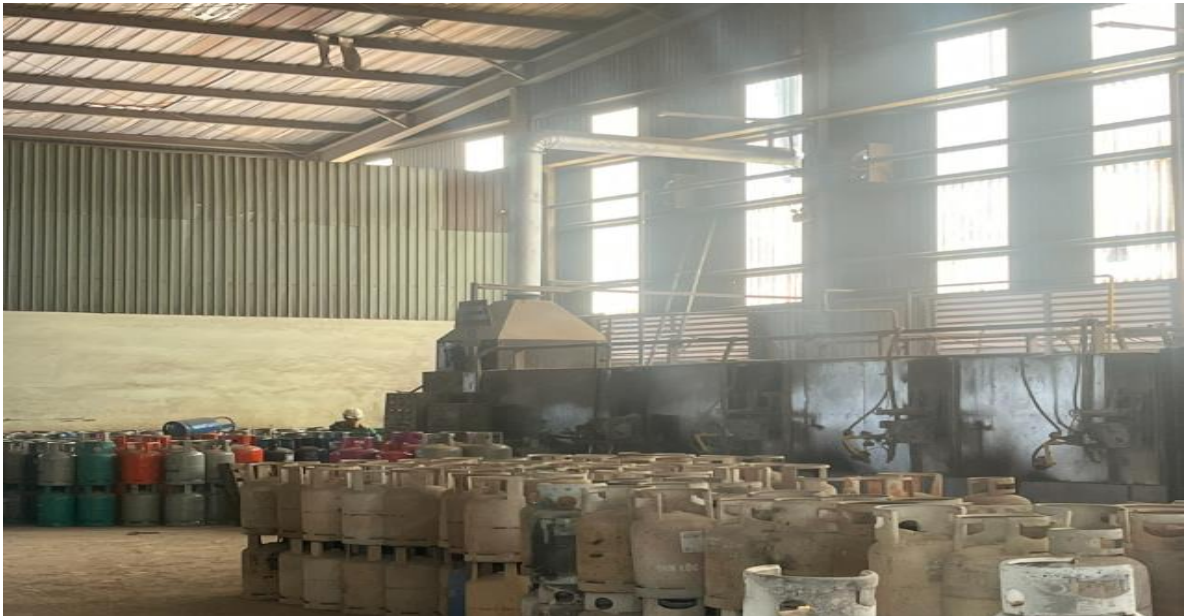
Hệ hồng lọc bụi quá trình xử lý khí thải lò đốt sơn vỏ chai LPG xưởng mới
