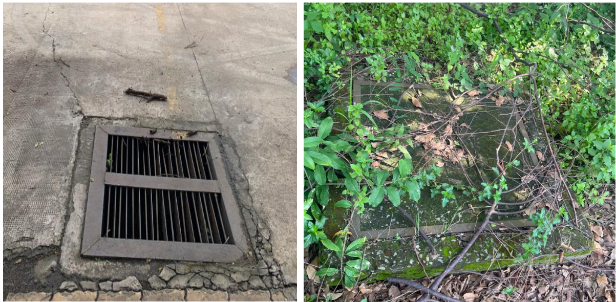
Hố ga thoát nước mưa
